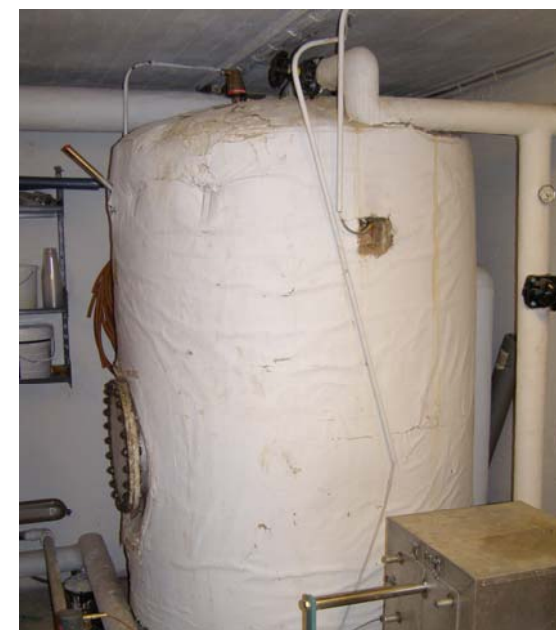
Varmtvandsbeholder i teknikrum med asbestholdig isolering.
