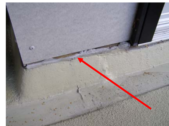
Utætte/defekte gummifuger ved lette facader/altangang.
