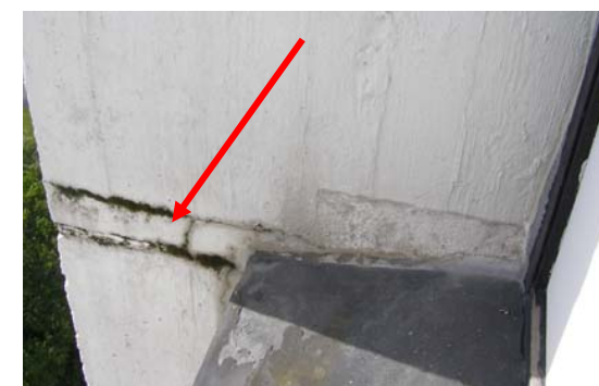
Algebegroning og mindre revner i beton på sydfacade.
