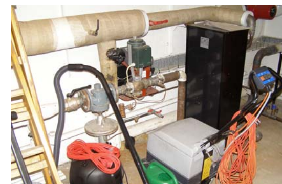
Del af basisinstallation i teknikrum kælder
