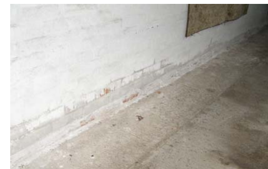
Opstigende fugt i indvendig væg.
