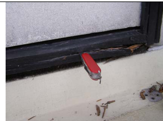
Rådskadet træliste ved vinduer/vinduesbrystning på 14. etage.
