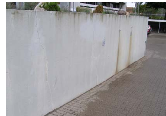
Kælderydervæg/støttemur med en del revner
