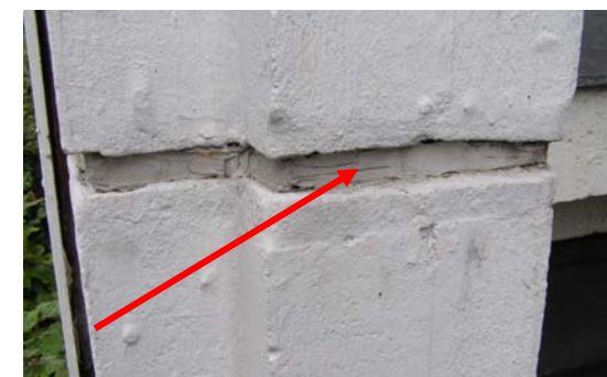
Nedbrudt og utæt dilatationsfuge.
