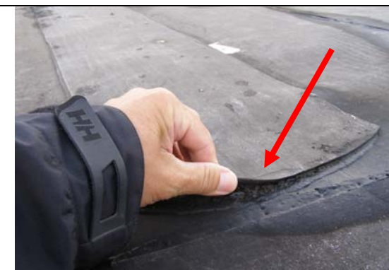
Forstærkningslapper uden fuld vedhæftning, risiko for utæthed.
