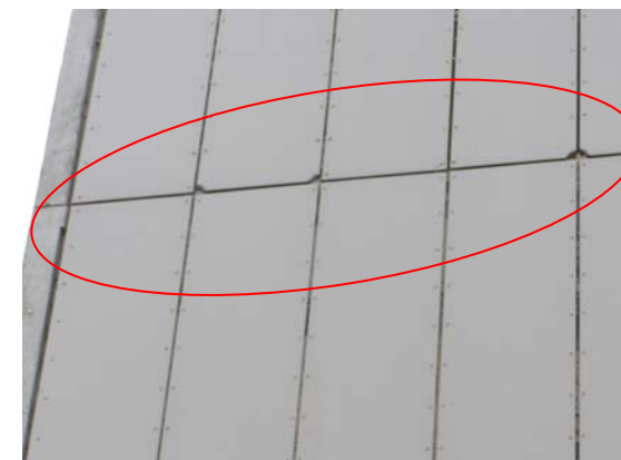
Revne i hjørner på facadebeklædning
