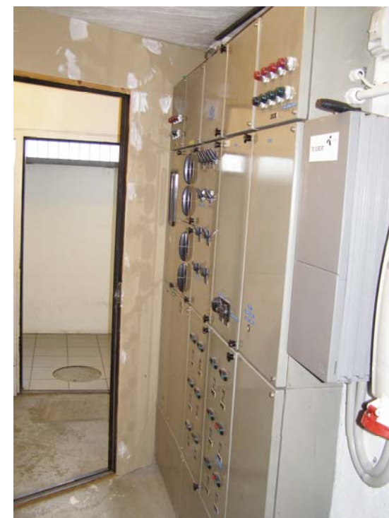
Hovedinstallation findes i teknikrum..
