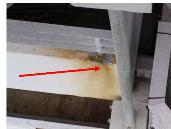
Eksempel på rusttæring af stålgelænder.
