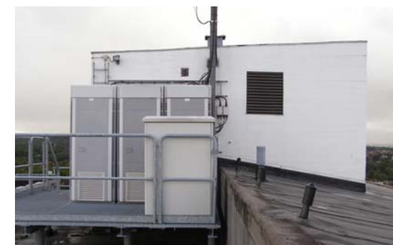
Teknikhus med rusttærede facadeplader
