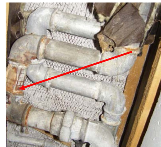
Tærede samlinger og bøjninger på stålrør i lejlighed 307.
