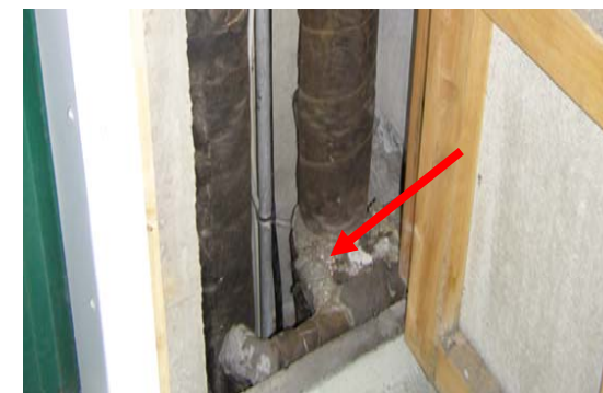
Isolerede varmerør, samt ældre ineffektiv isolering på lodrette rør
