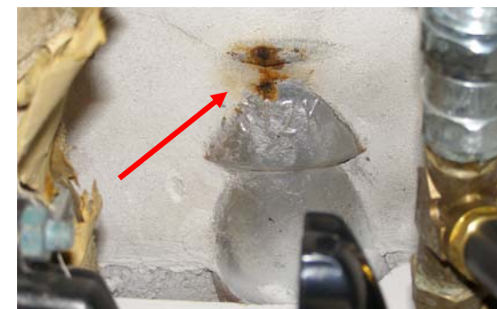
Begyndende rusttæring på faldstammer i kælder.
