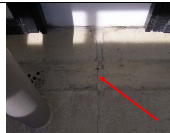
Eksempel på utæt dilatationsfuge på altangang.
