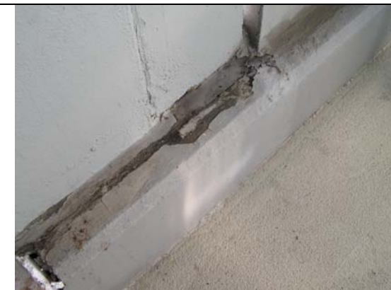
Revner ved sammenbygning mellem trappetårn og altangang.
