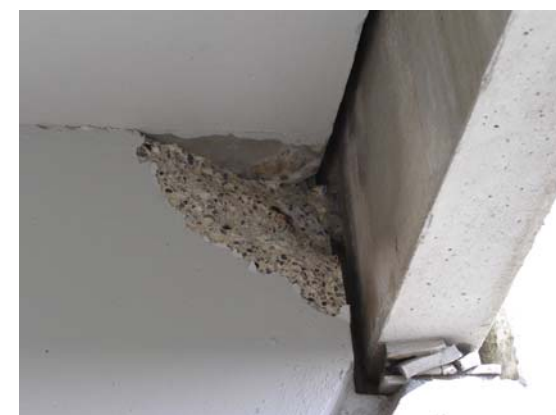
Betonafskalning på betondrager.
