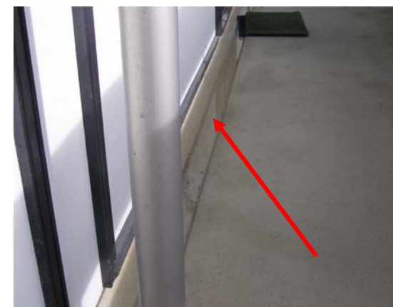
Opstuvning af regnvand på altangang
